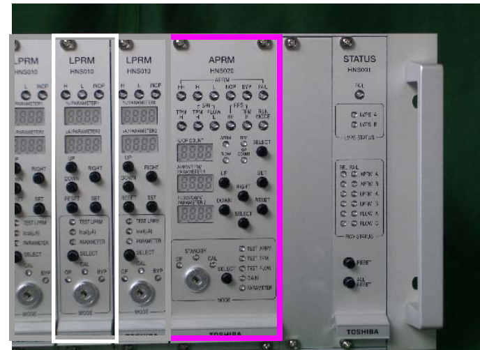
LPRM Modules APRM Module
